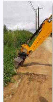
Nettoyage de voiries après l'affaissement d'un talus.
