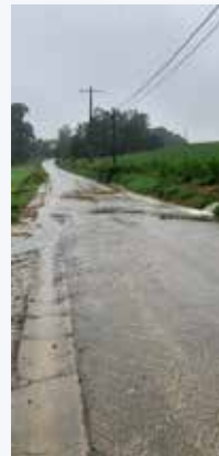
Affaissement du talus.
